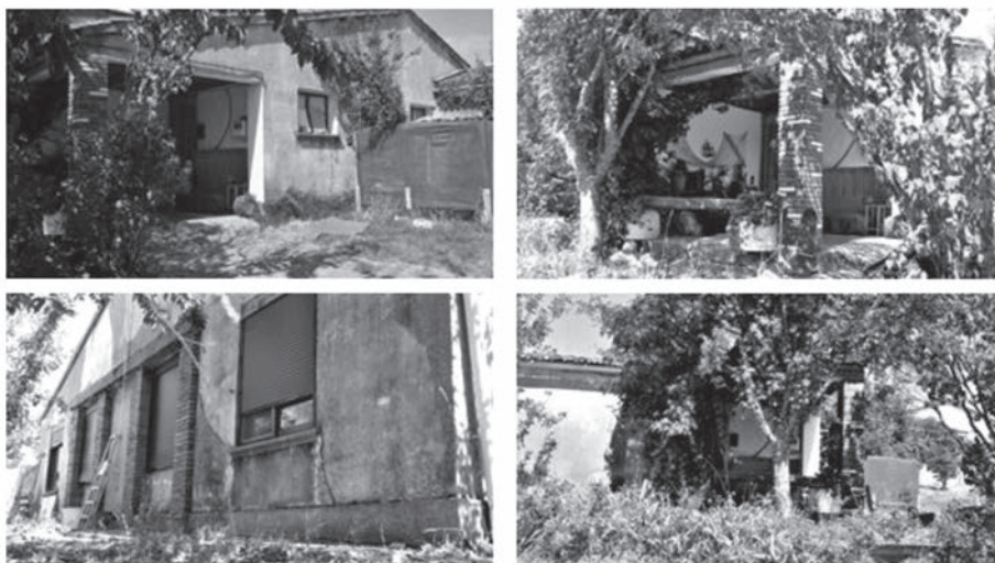
Estado actual de la vivienda construida en 1957, con destino a la maestra.
