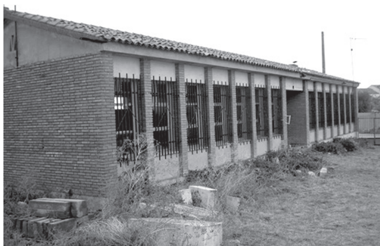
Escuelas nuevas. Originalmente no había rejas en las ventanas.
